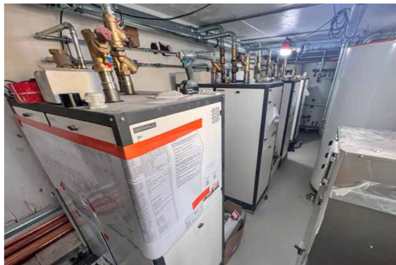
Maalämpöjärjestelmää teknisessä tilassa
