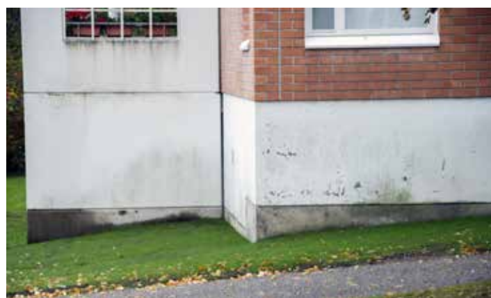
Lähellä rakennusta kasvaneet pensaat vaurioittavat seinäpintoja.
